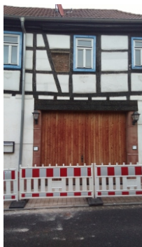
Von der Außenfassade der Gaststätte „Zum Schwanen“ fiel erst kürzlich ein Teil vom Putz der Außenwand auf den Gehsteig. Die SPD hat inzwischen beantragt, dass ein Gutachter untersucht, ob dies den Erschütterungen durch den Schwerlastverkehr geschuldet war.
