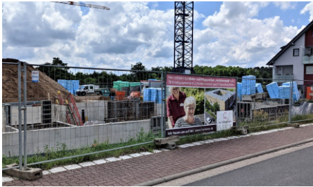
Wo heute noch die Baukräne stehen und das Fundament betoniert wird, sollen Ende 2022 die ersten Bewohner einziehen.
