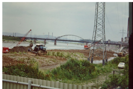
Auch der Bau des Maindamms wurde seinerzeit im Bild festgehalten. Im Hintergrund die Eisenbahnbrücke, die 1955 fertiggestellt wurde.
